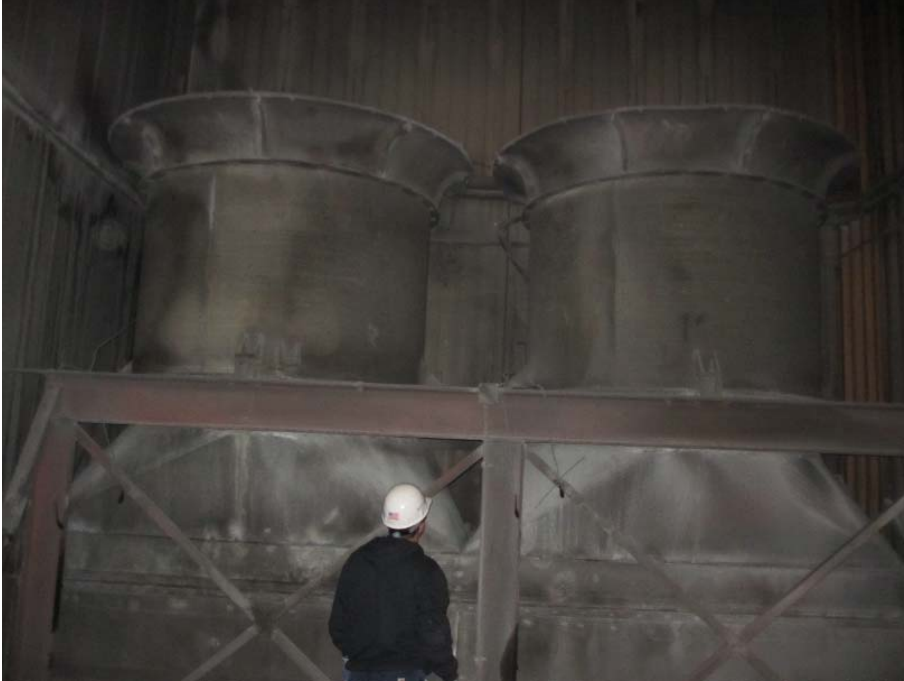
Fan intake inside mixer room
